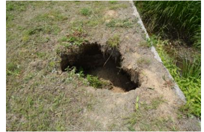
4 番砂留左岸部陥没
